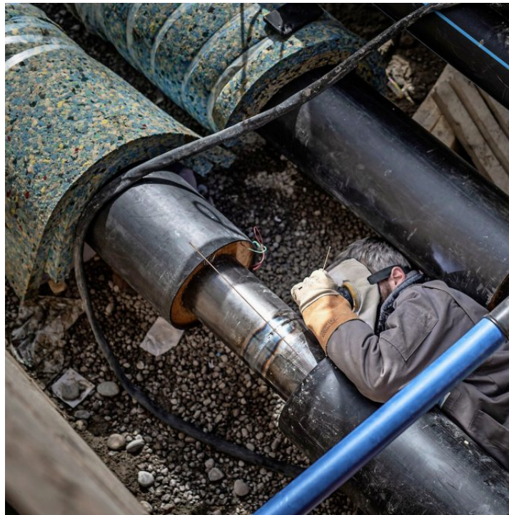
Das Fernwärmenetz wird kontinuierlich ausgebaut.
