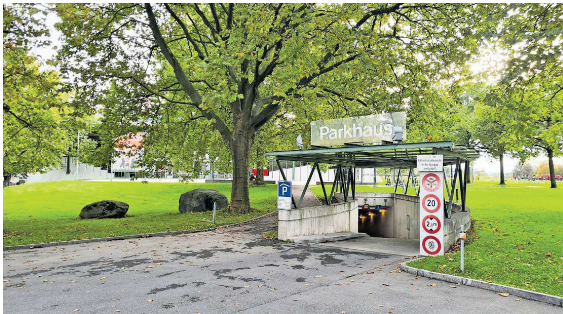
Die Einfahrt in die Tiefgarage unter der Sporthalle Kreuzbleiche. Die Anlage ist 40 Jahre alt und sanierungsbedürftig.
